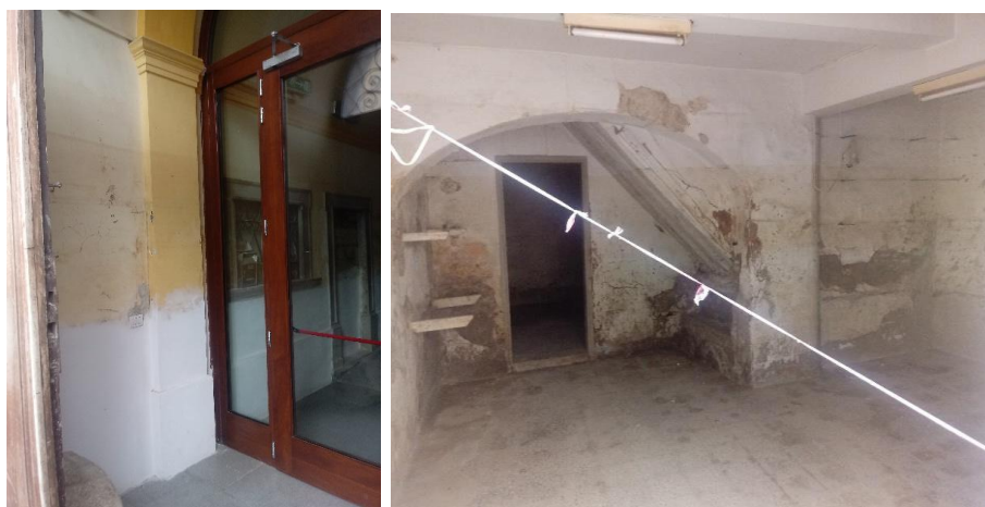
Fig. 2 - Livello raggiunto dall'acqua in alcuni edifici del centro di Cantiano. A sinistra l'ingresso del Municipio.
