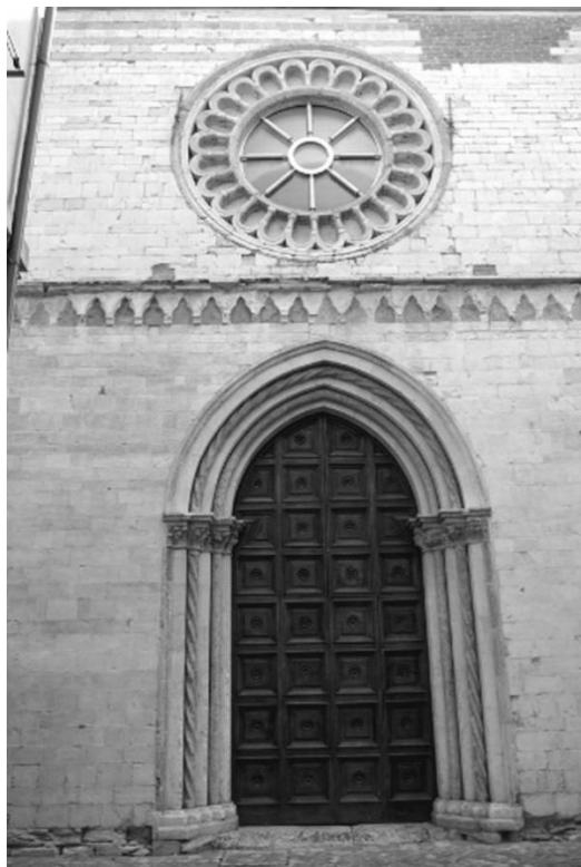
Figura 3. La fachada de la ex Iglesia de Santa Caterina después de la restauración (2011).
