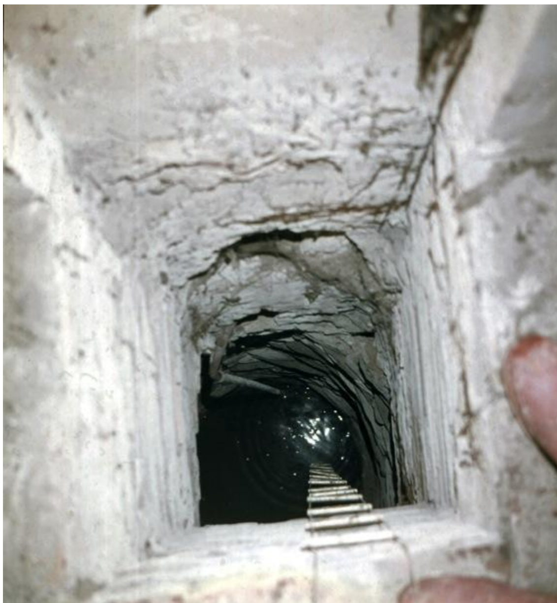
Fig. 9.3 – Documentazione fotografica dell'attività esplorativa in data 13 gennaio 1976 del pozzo n. 9, presso la Confraternita della Misericordia.
